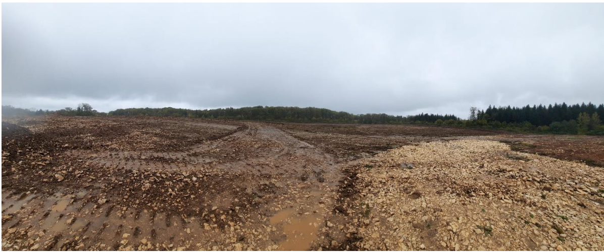
Illustration 2 : Etat des terrains en octobre 2023 - Terre végétale décapée sur la totalité de la surface
