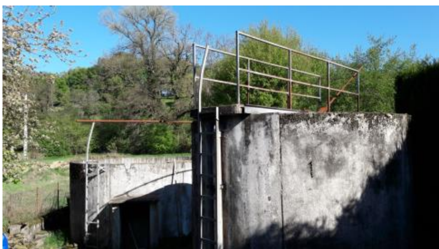
Figure 4 : Station de traitement des eaux usées
