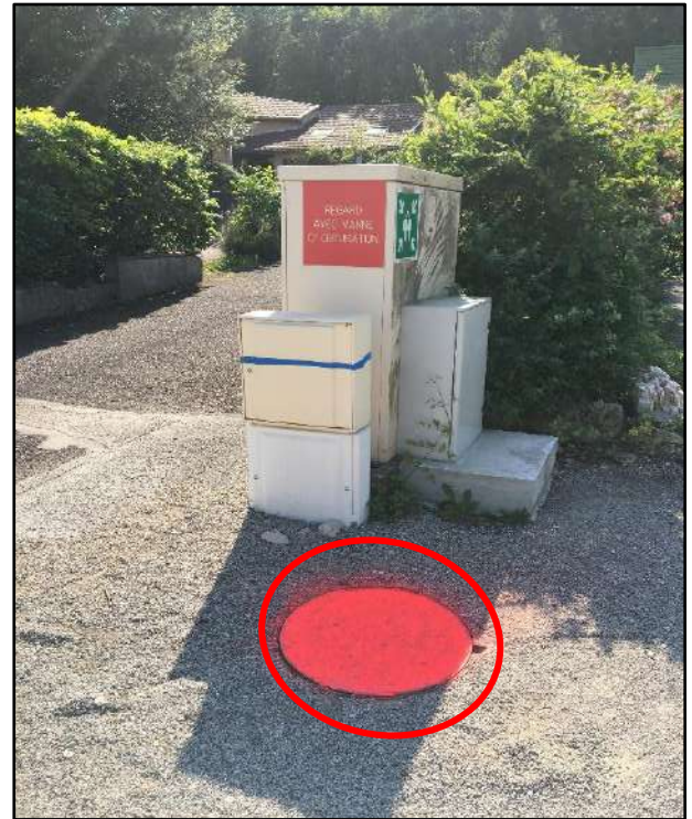
Figure 2 : Regard avec vanne d'obturation des eaux pluviales
