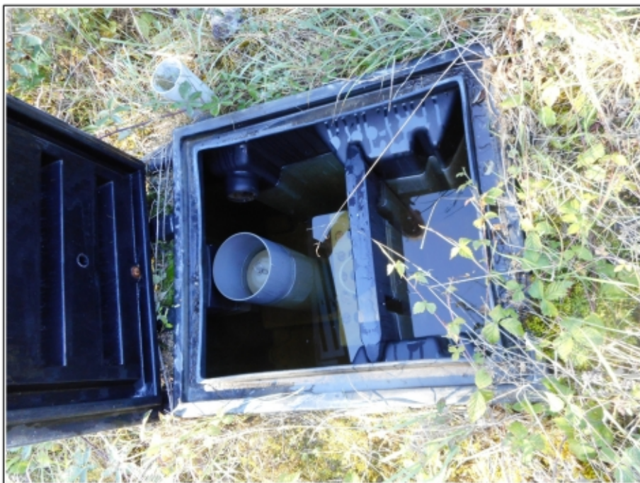
Dispositif décanteur deshuileur de l'aire étanche
