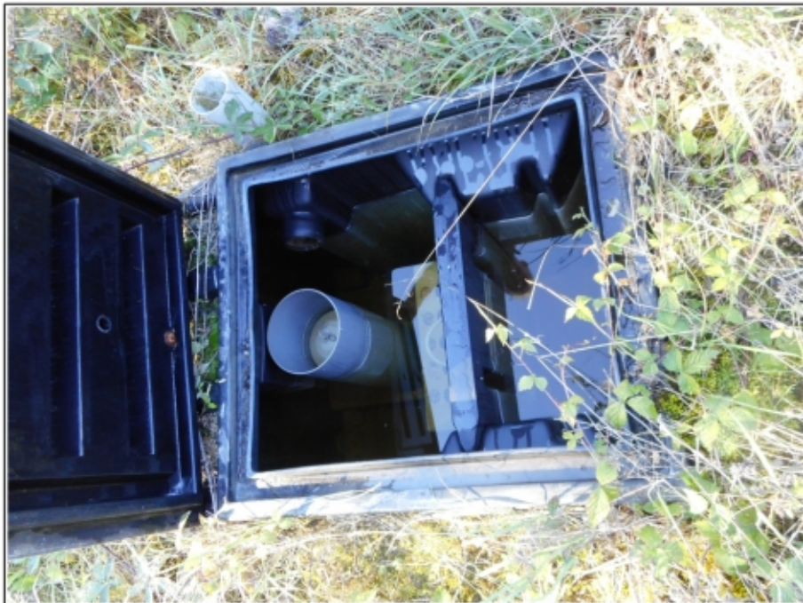
Dispositif décanteur deshuileur de l'aire étanche
