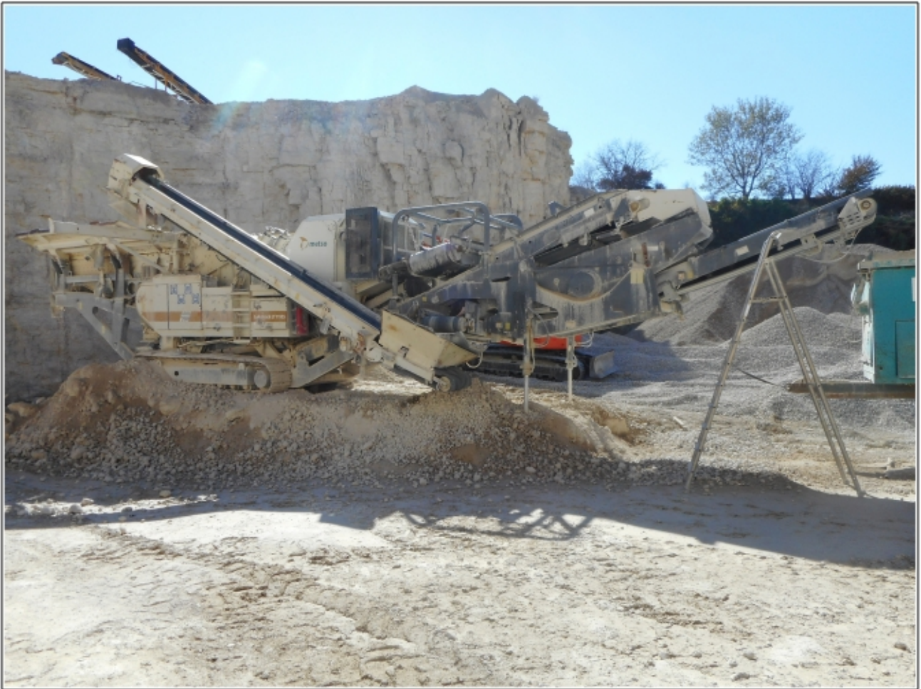
Installation de concassage primaire
