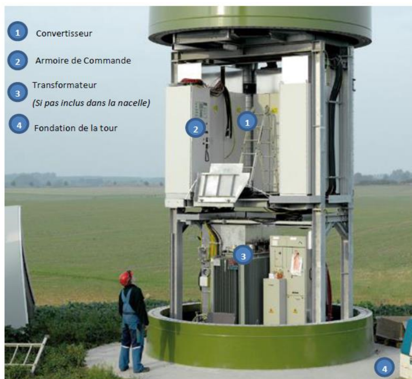
Illustration 8 : Transformateur inséré dans le mât (Enercon)
