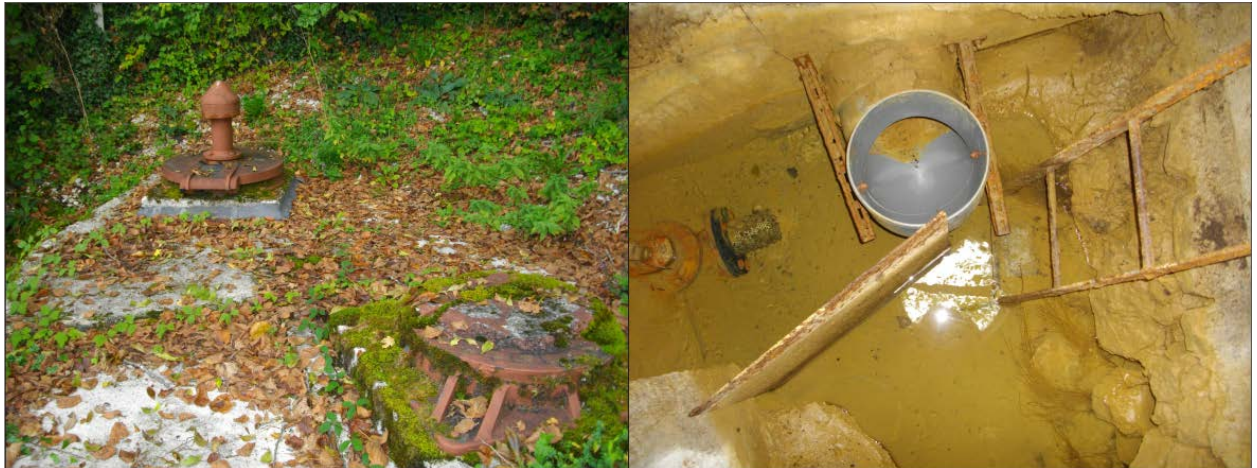
Figure 15 : Vues de l'extérieur et de l'intérieur du captage de la Ville
