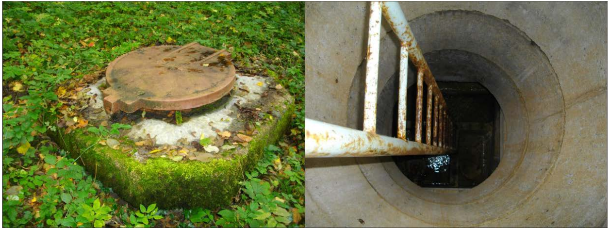
Figure 4 : Vues de l'extérieur et de l'intérieur du captage de Plainchamps
