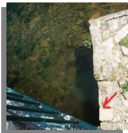
Rejet d'eaux pluviales Photo Commission de Protection des Eaux
