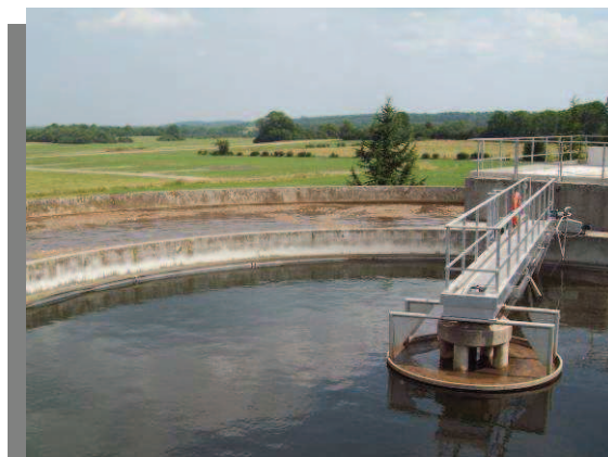
Station d'épuration à boues activées
