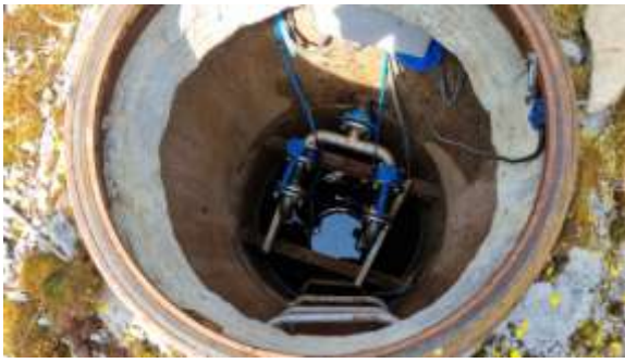
Le puits et ses deux pompes
