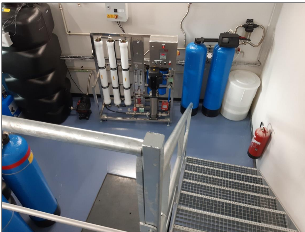
Figure 10 : Photographie de la zone STEP -Adoucisseur et osmoseur
