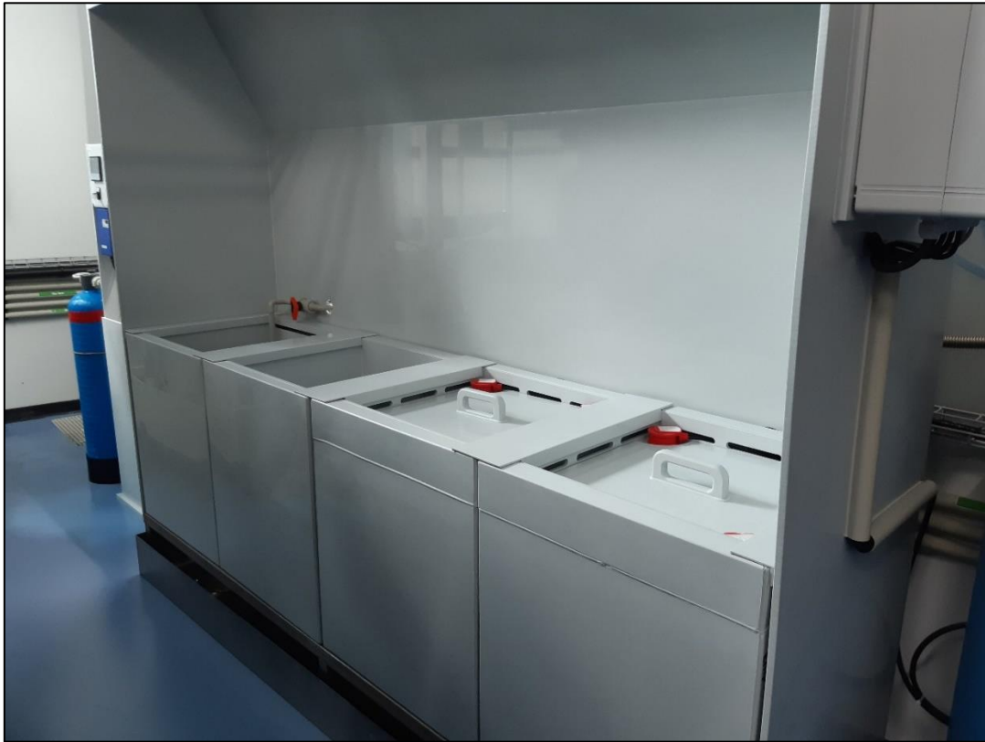
Figure 13 : Photographie de la zone STEP - Cuves "Stripper", récupération et rinçages associés
