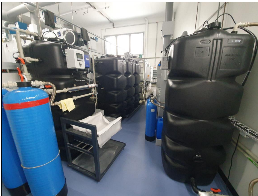
Figure 11 : Photographie de la zone STEP – Poste Résines Recyclage Eau, cuves tampon et cuve neutralisation (à gauche)
