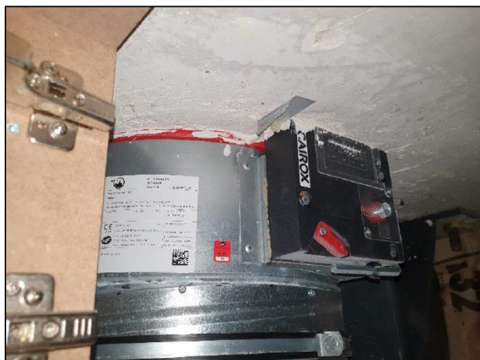
Figure 2 : Photographie du dispositif de clapet coupe-feu installé sur le système d'aspiration
