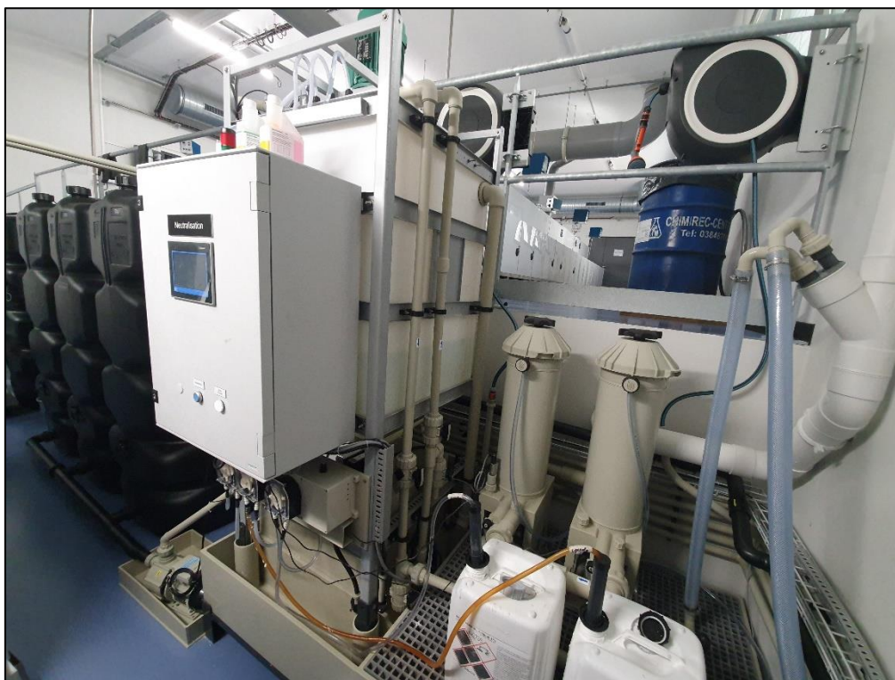
Figure 12 : Photographie de la zone STEP – Poste neutralisation avec cuve
