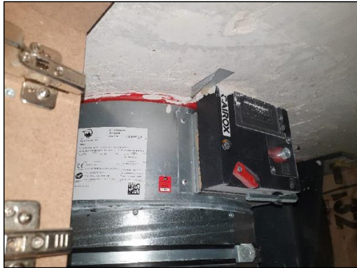
Figure 15 : Photographie du dispositif de clapet coupe-feu installé sur le système d'aspiration
