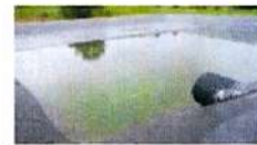
Bassin et réserve
