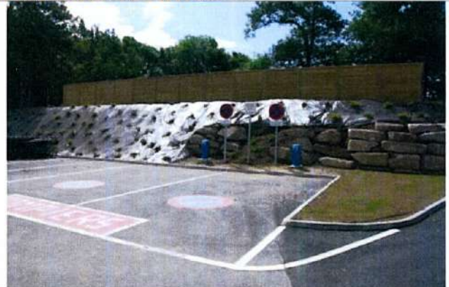
2 plateformes d'aspiration sur une réserve d'eau équipées de deux poteaux d'aspiration de 150 mm
