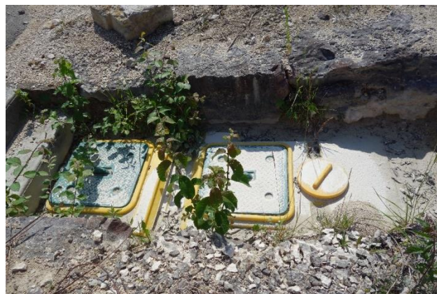
Photographie 12 : Regards du décanteur déshuileur de la carrière d'Etalans
