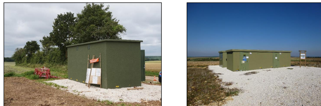
Figure 30 : Exemples de postes de livraison – Source : Cohérence Energies
