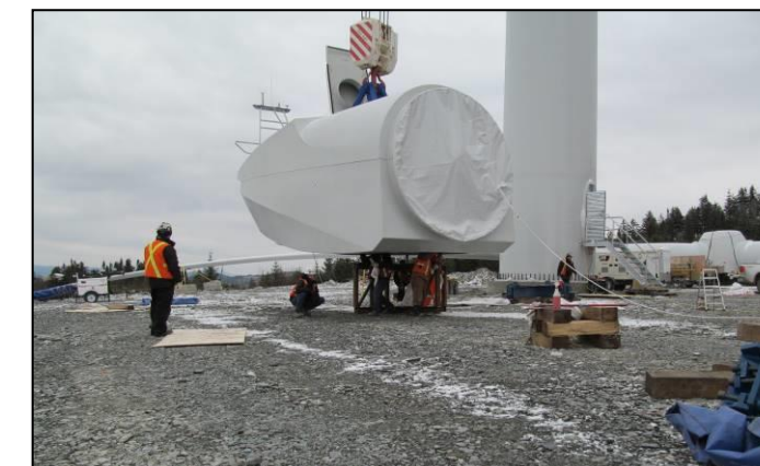
Figure 46 : Nacelle d'une éolienne – Source : MWEnergies
