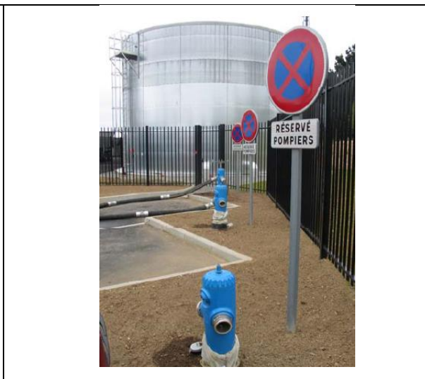
Réserve aérienne équipée de 3 poteaux d'aspiration de 150 mm
