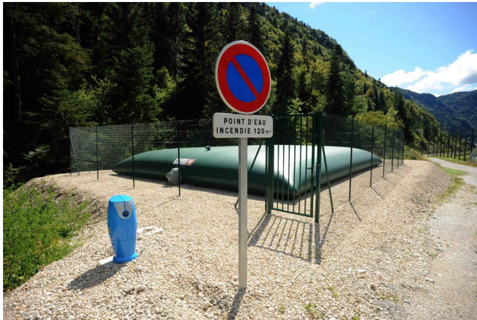
Dispositif avec un poteau d'aspiration alimenté par une réserve incendie souple
