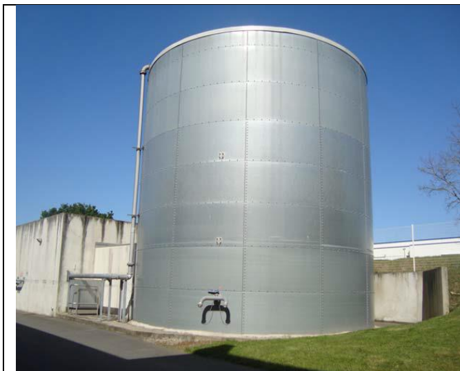
Réserve aérienne munie de deux sorties de 100 mm
