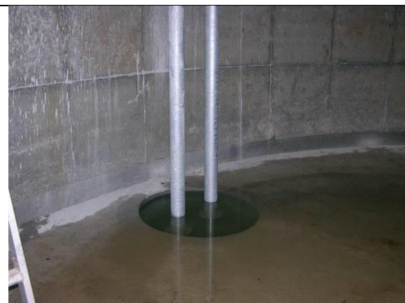
Fond de la cuve avec crépine en partie basse pour utiliser la totalité de l'eau contenue
